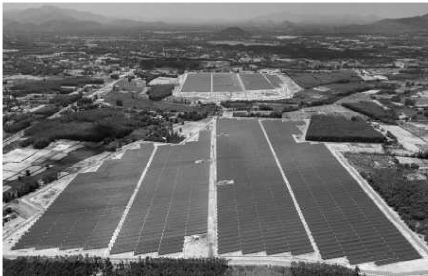
Hình 6: Nhà máy điện mặt trời Cát Hiệp
