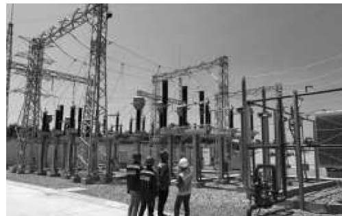
Trạm biến áp 110kV tại Nhà máy
